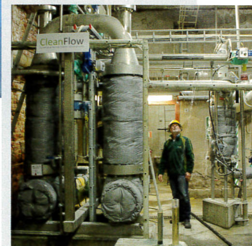
Anläggningen i Aspa Bruk är den första grönlutsreningen med mikrofiltrering i världen patenterad och levererad av det värmiländska företaget CleanFlow.
